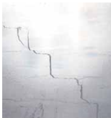
Beispiel 6: Diagonalriss, Wand, KG
