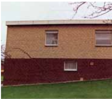
Beispiel 8: Setzungsschaden Wohnhausecke
