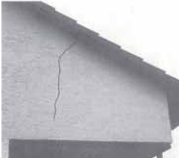
Beispiel 7. Schrägriss in Giebelwand
